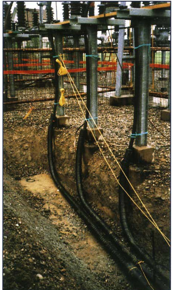
Alimentation de poteaux de haute et basse tension
