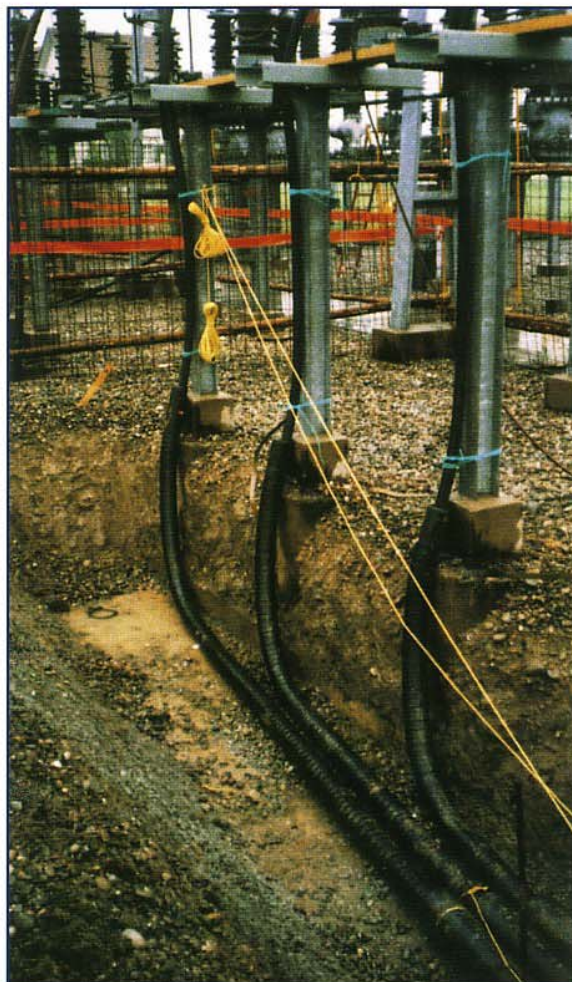
Mastaufführungen für Stark- und Schwachstromleitungen
